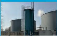
BIOGASSTATION RWZI LEEUWARDEN
